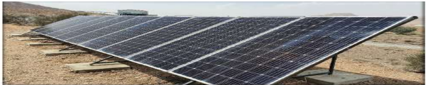
پروژه پنل خورشیدی پمپ آب استخر گوشقیل
