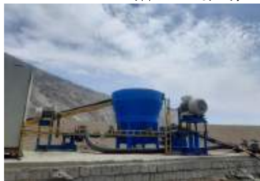
ایستگاه جدید پمپاژ باطله
